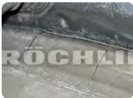
Трещины вследствие внутренних напряжений
