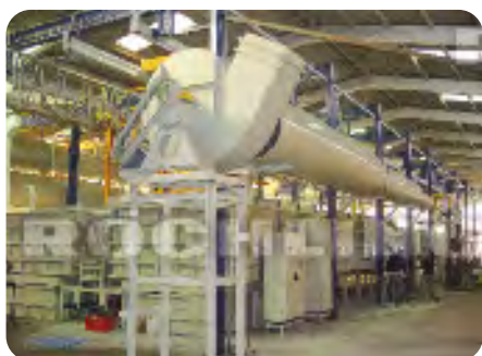
Polystone® P гомополимер серый Вентиляционная система для гальванической установки
